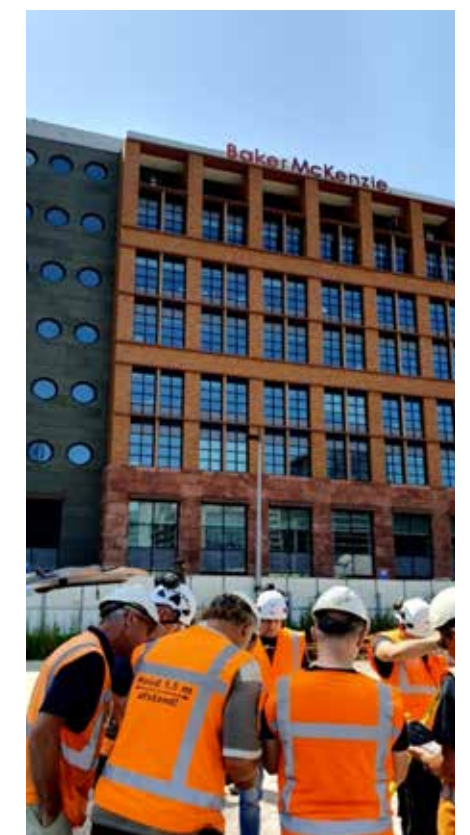
Ook het op afstand meekijken door de projectleider, werkvoorbereider, een tweede maatvoerder of zelfs de klant zal er zeker toe bijdragen dat er minder fouten gemaakt gaan worden in het totale bouwproces.
